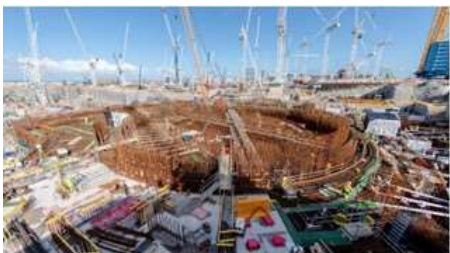
Fin 2027 : 1 er béton de l'îlot nucléaire : JO unité n°1 (2029 pour l'unité n°2)
